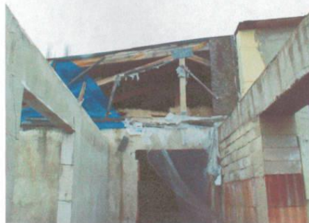
Zatékání na krajní vazník skladů nedokončenou střechou šaten
