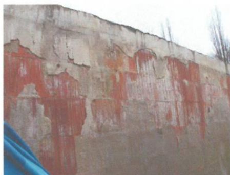
Opadávání omítky ze stěn šaten
