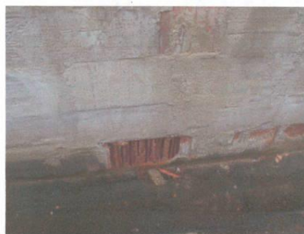
Spodní řada cihel šaten s lokální poruchou
