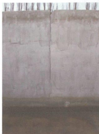
Trhlina plynosilikátové příčky
