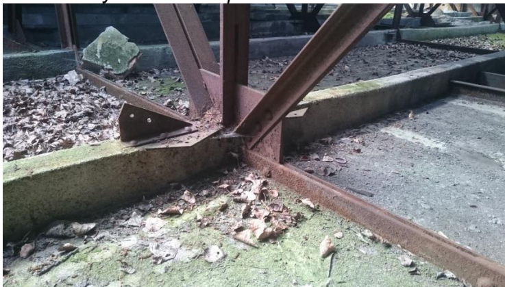
Obr.: Styčník příhradové konstrukce, absence prostorového ztužení
