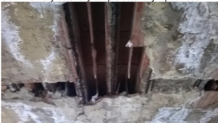
Obr.: Odpadlá spodní vrstva vložek keramického stropu, koroze výztuže
