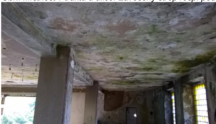
Obr.: Výkvěty na pohledu nad ochozem
