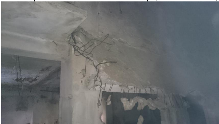
Obr.: Spadlá konstrukce římsy
