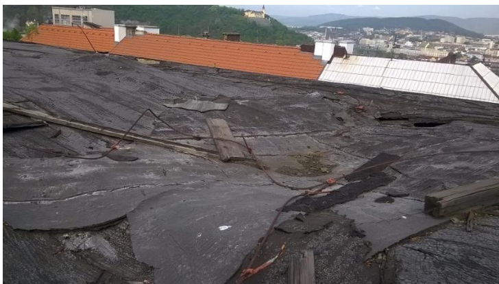
Obr.: Výhled na středu z místa propadu záklopu střechy
