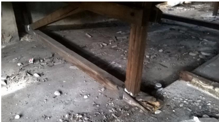
Obr.: Krov na štítových stranách. Značná degradace dřevěných prvků.
