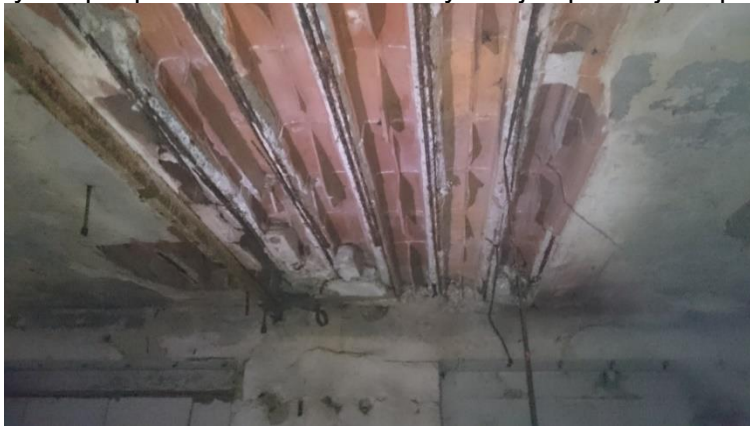
Obr.: Odpadlá vrstva keramického stropu, značná koroze, některé pruty scházejí
