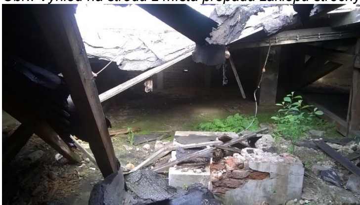
Obr.: Pohled na propadlou střechu
