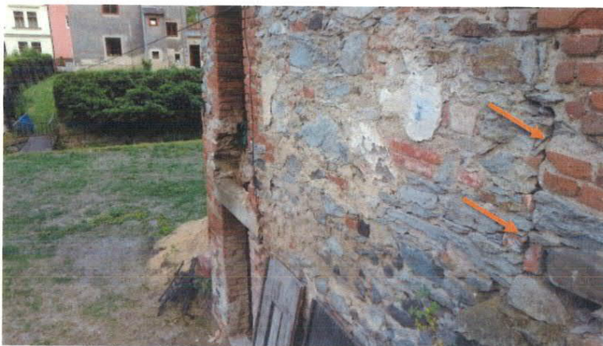
obr. 6 Severní stěna s trhlinou
